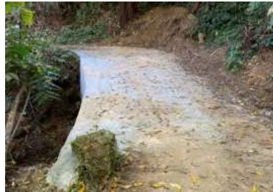
清水溝營林區12林班田坪山農路路基 掏空施工後
