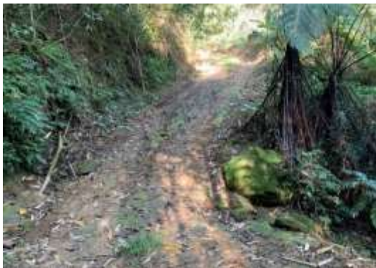
清水溝營林區12林班田坪山農路路面 沖蝕施工前
