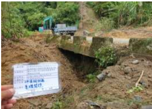
清水溝營林區「坪溪湖林道路基沖蝕掏空」施工前
